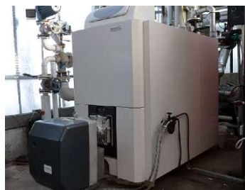
Heizkessel Brötje Brenner 175 kW Kesselinhalt 184 l CO-Emission 28 ppm
